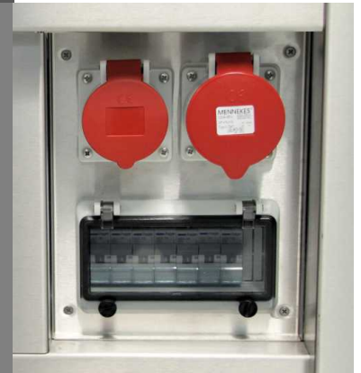
Steckdosen und Schaltkasten Sockets and switchbox
